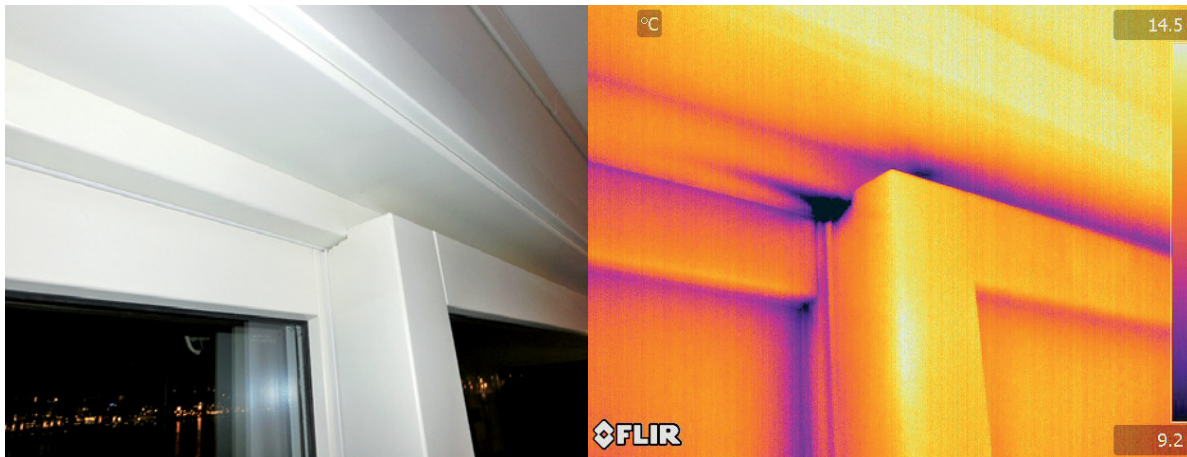
Figur 3.5: Termografering av luftlekkasjer rundt skyvedør. Foto: Omega Termografering AS.
