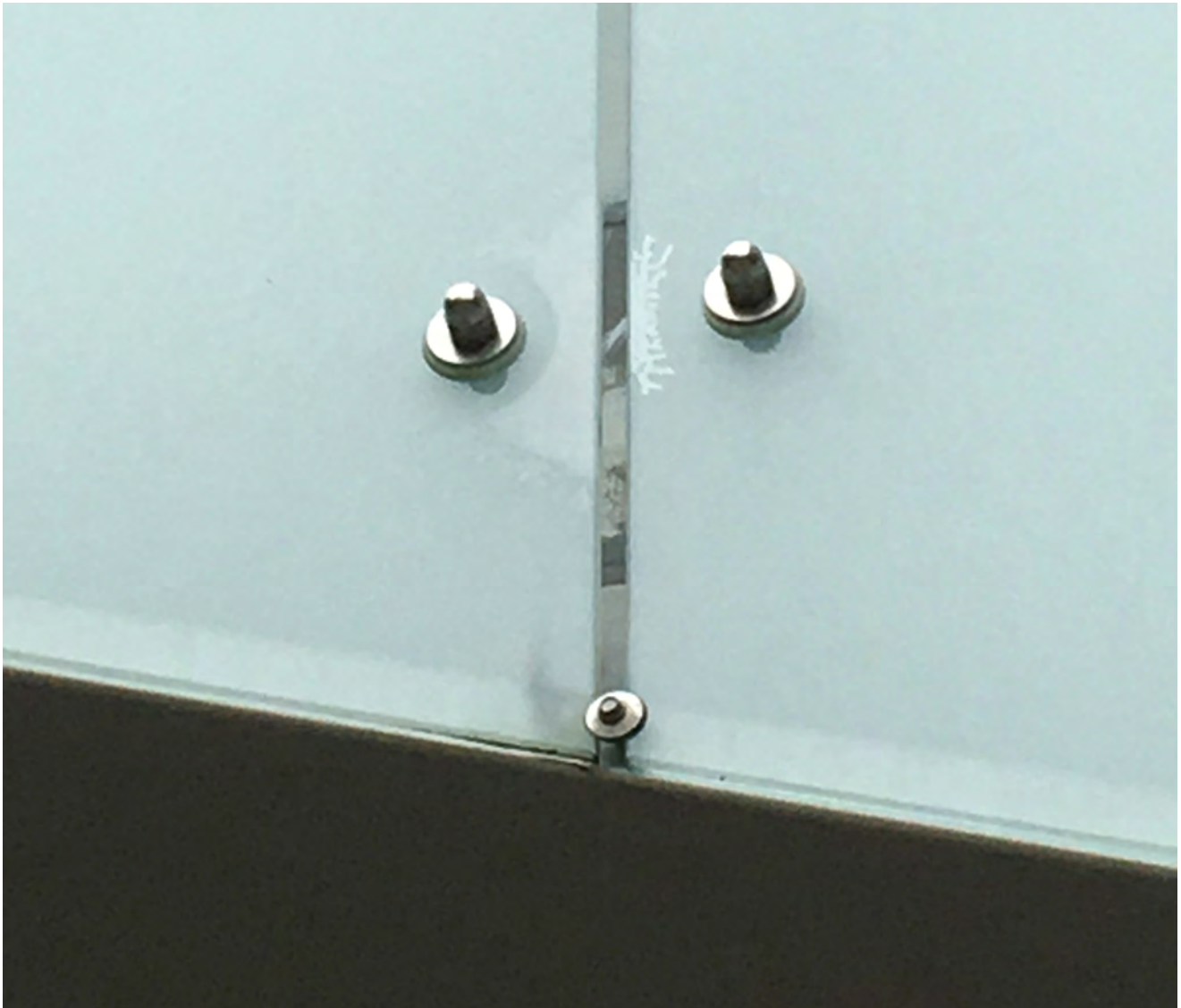
Bilde 4: Delaminering i området rundt punktfixerte skyldes ofte feilposisjonering av hull og/eller for hard tilstramming. Se også bilde 2.
