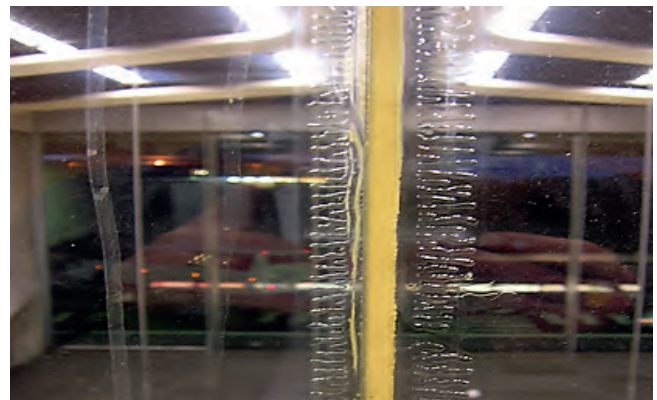
Bilde 5: Eksempel på delaminering som skyldes fugemasse som ikke er kompatibel med laminatfolien i glasset.
