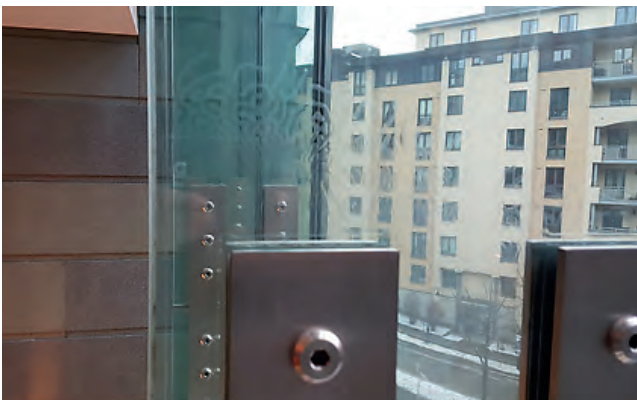
Bilde 2: Eksempel på delaminering typisk for montering med for hard tilstramning av festepunkter.
