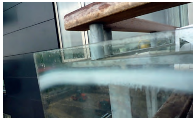
Bilde 3: Eksempel på delaminering og misfarging som følge av fuktinntrengning.
